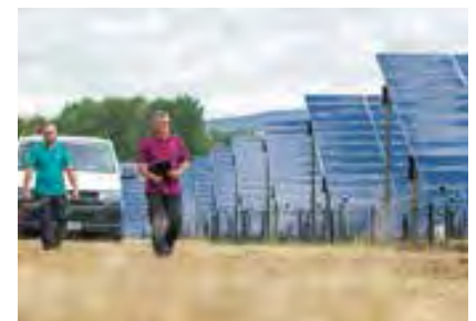
Der Ausbau von Anlagen zur Gewinnung von Erneuerbaren Energien hat zugenommen.
