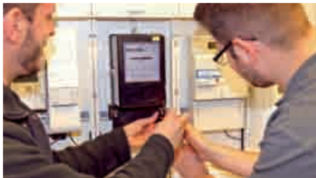
Der Austausch der Stromzähler muss generalstabsmäßig geplant sein.
