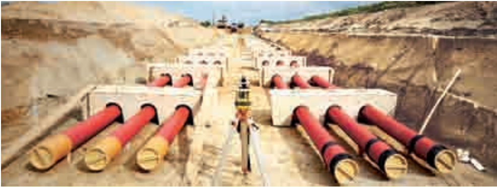
Bürgerinitiativen fordern neue Erdkabel. Allerdings sind diese teurer und schwieriger zu verlegen.
