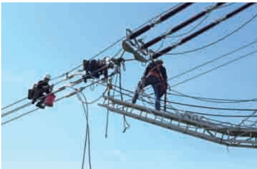
Gleichstromkabel sollen auf bestehenden Hochspannungsmasten neben Wechselstromkabeln verlegt werden. Das bedeutet: kaum neue Trassen. Gegner befürchten unerforschte elektromagnetische Felder.
