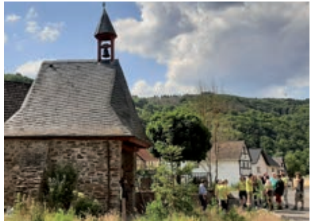
Die Hubertuskapelle aus dem 17. Jahrhundert in Hönningen, die weniger als 50 Meter vom Ahr-Ufer entfernt steht, wurde schwer beschädigt und mittlerweile liebevoll restauriert.
