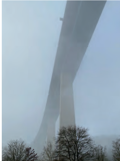
Experten stochern noch im Nebel: Wie gelingt die Sanierung der Moselbrücke, ohne die Verkehrsströme massiv zu behindern?
